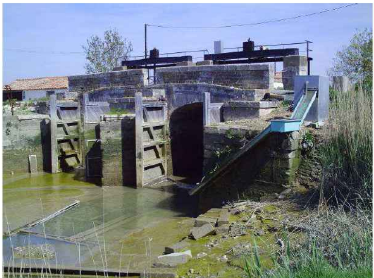
Fig.2 : Passe à anguille des Portes des Cinq Abbés
